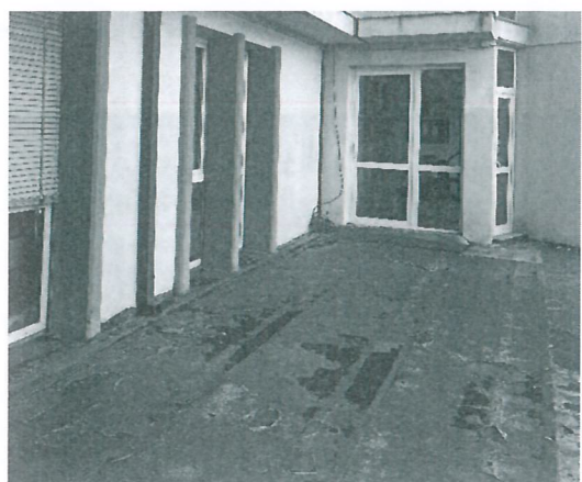
Guaina Terrazzo Piano Interrato degradata
